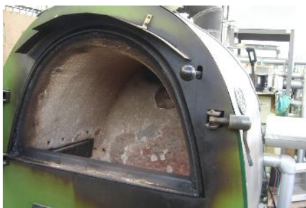
写真-3 ボイラ薪投入口
