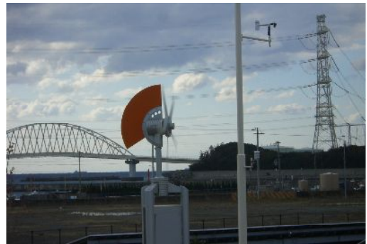
写真-8 200W 水平軸型（プロペラ型） 風力発電設備
