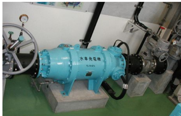
写真-6.7 インライン型発電（岸和田市）
