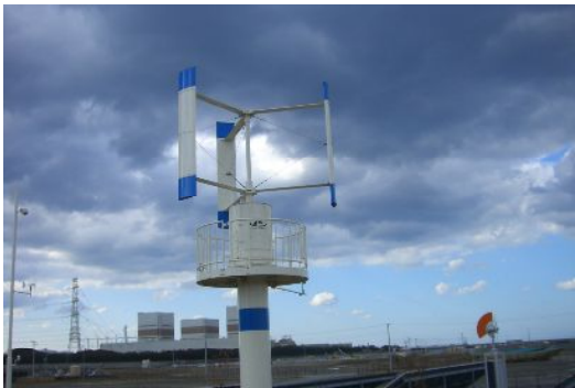
写真-7 5kW 垂直軸型風力発電設備
